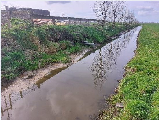
Voorbeeld waarbij de oever is ingestort waar geen bomen staan en niet is ingestort waar wel bomen staan.
